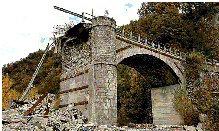
Il ponte il giorno del crollo il 3 ottobre 2020
