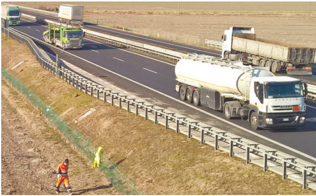
Dal 2 maggio i lavori sono entrati nel vivo tra il ponte sul Tagliamento ed il casello di San Giorgio di Nogaro
